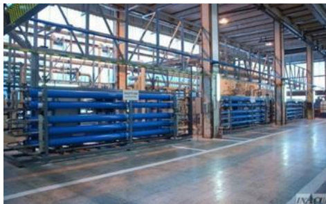
2. ábra. A Tiszai Erőmű fordított ozmózisos elősótalanítója
