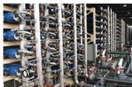
30000 m 3 /nap RO sótalanító telep
